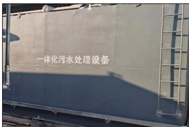
自建污水处理设施图
