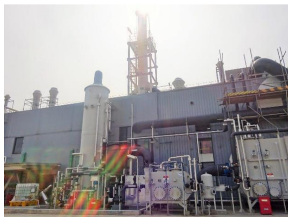
有机废气处理设施 (FQ-06)
