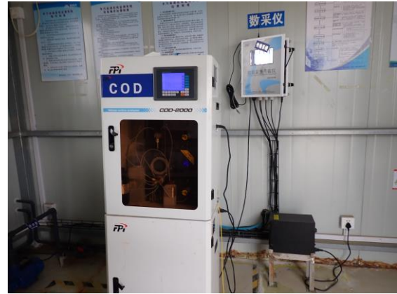
雨水在线监测站房设备
