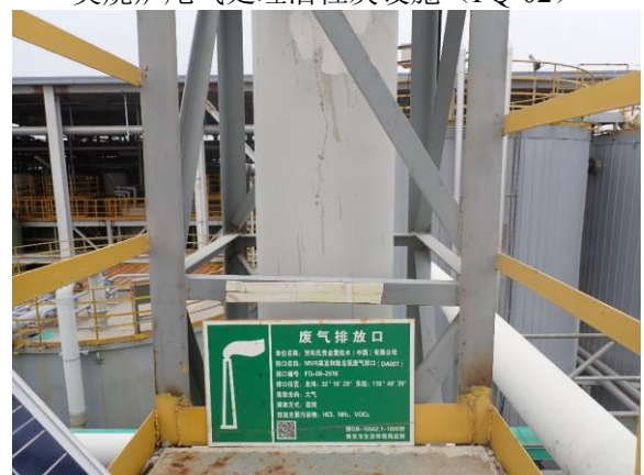
废水除总氮装置废气处理设施 (FQ-08)
