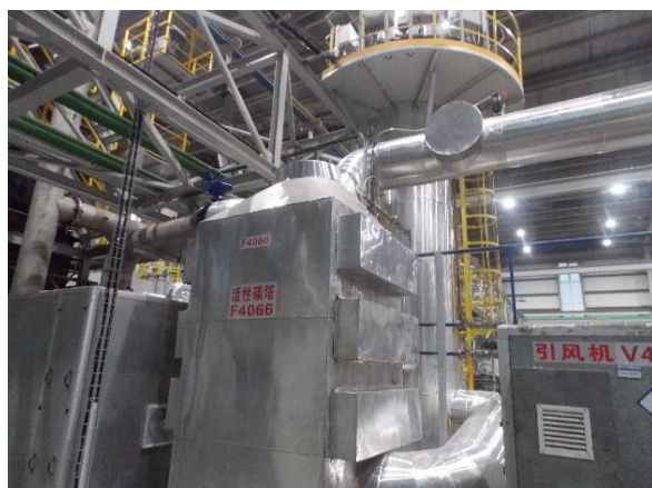
焚烧炉尾气处理活性炭设施 (FQ-02)
