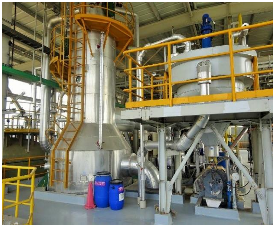
图 3.5.2-5 MVR 蒸发设备
