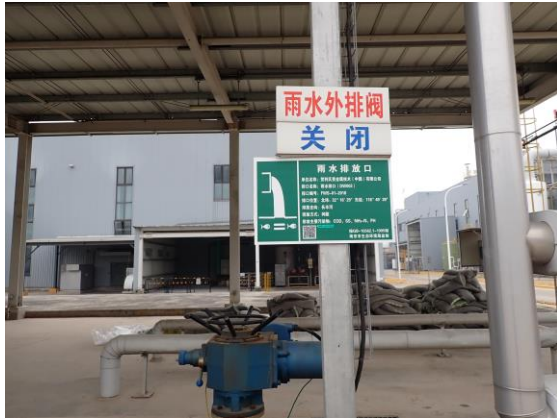
雨水排放口标识牌
