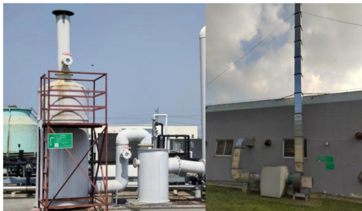
图 2-14 废气处理措施及排气口照片
