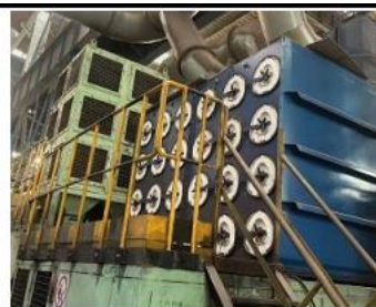
抛丸机除尘设备
